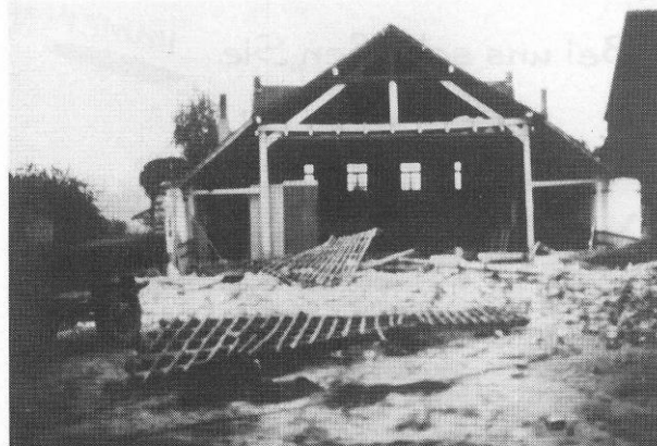
1974 - Beginn der Arbeiten für den neuen Schützenaal - der alte Saal ohne Vordergiebel
